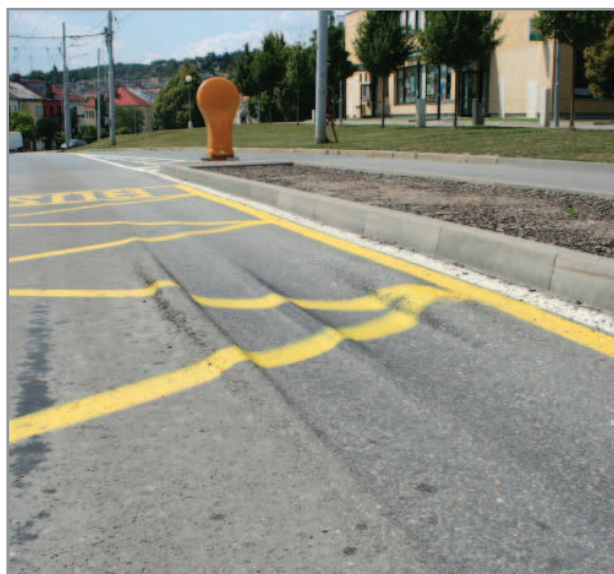
Obrázek 7: Vyjeté koleje v prostoru zastávky hromadné dopravy - špatné odvodnění, problematická jízda cyklistů
